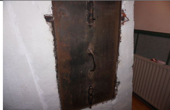
Spekluk in schoorsteen op verdieping
