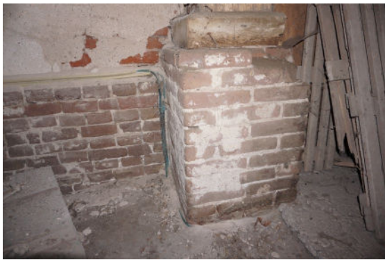
Gemetselde poer met houten plaat in bedrijfsgedeelte
